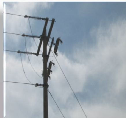
Electricity at Villa de Ramos, SLP / Club Unidos por San Luis (HTA) , Texas
